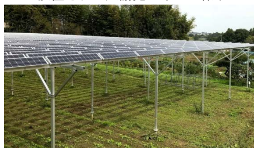
設置された太陽光パネルの様子
