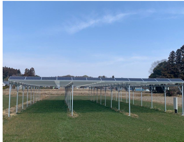
▲太陽光発電設備
